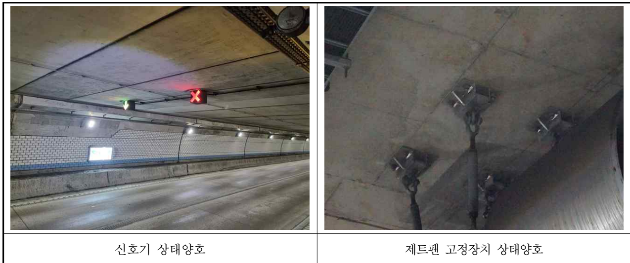
【사진 3.3.44】 기타시설 손상현황
