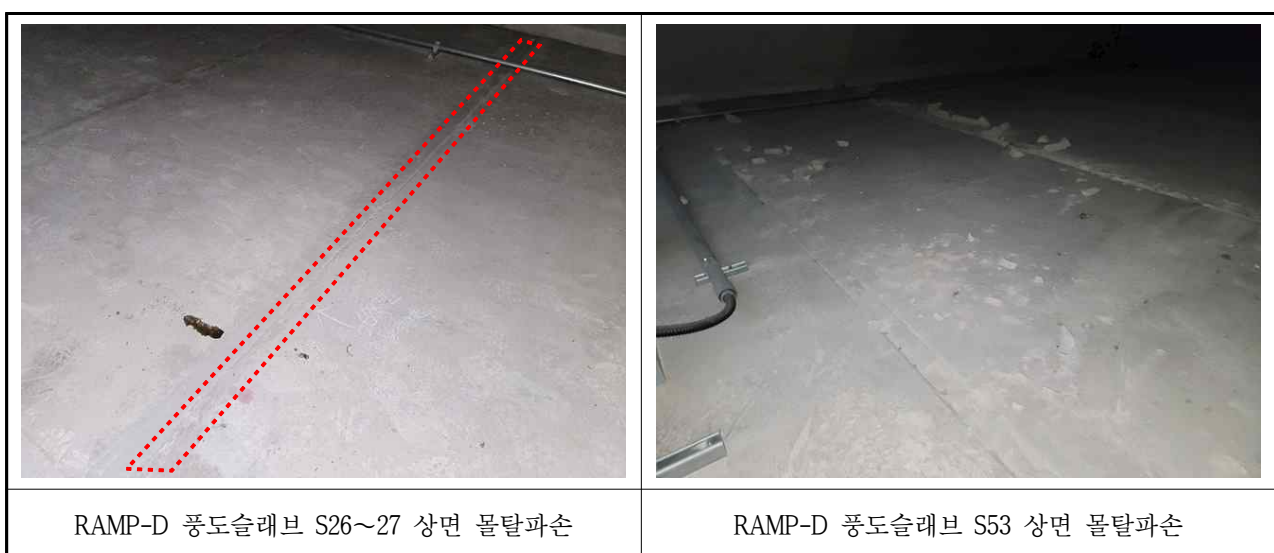
【사진 3.3.28】 NATM구간 풍도슬래브 손상현황
