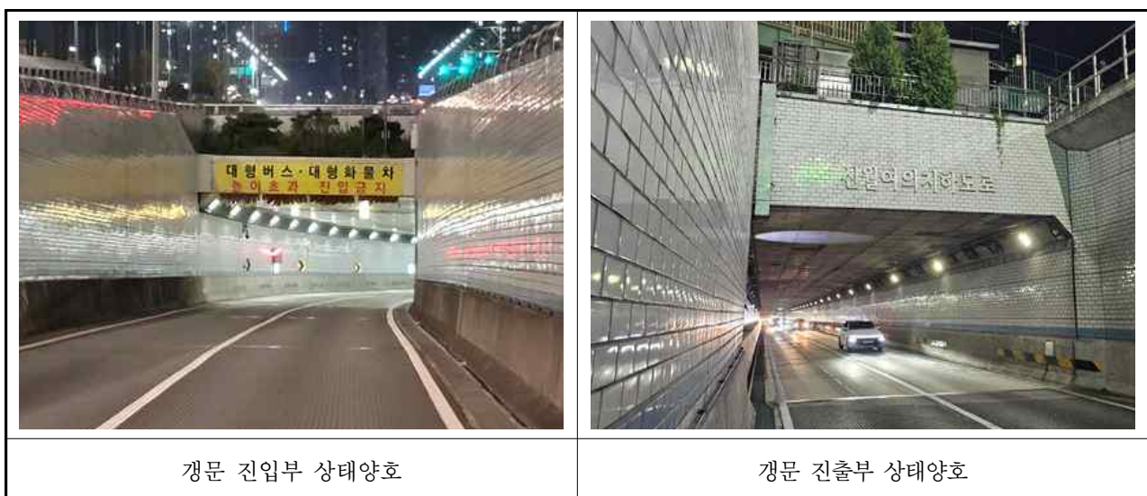
【사진 3.3.18】갯문 손상현황
